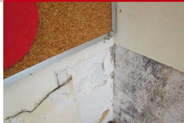
Erst der vom Gebäudenutzer eingebrachte Kleber verursachte eine Geruchsbelastung
