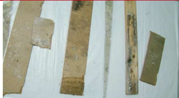
Flächen deckender Schimmelbefall auf der Rückseite von Paneelen
