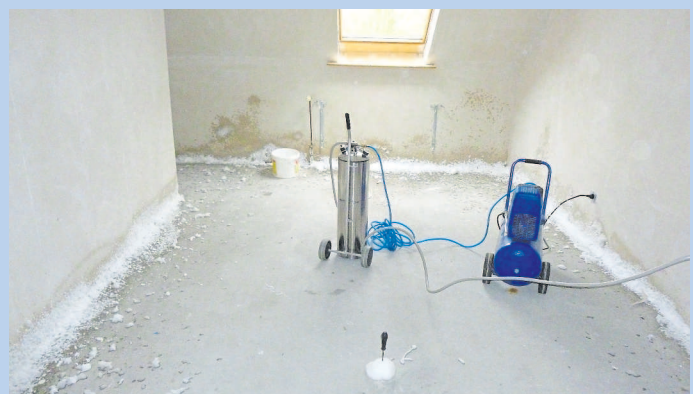
Bei Schimmelpilzbefall und Wasserschäden sollte der Fachmann zu Rate gezogen werden.
